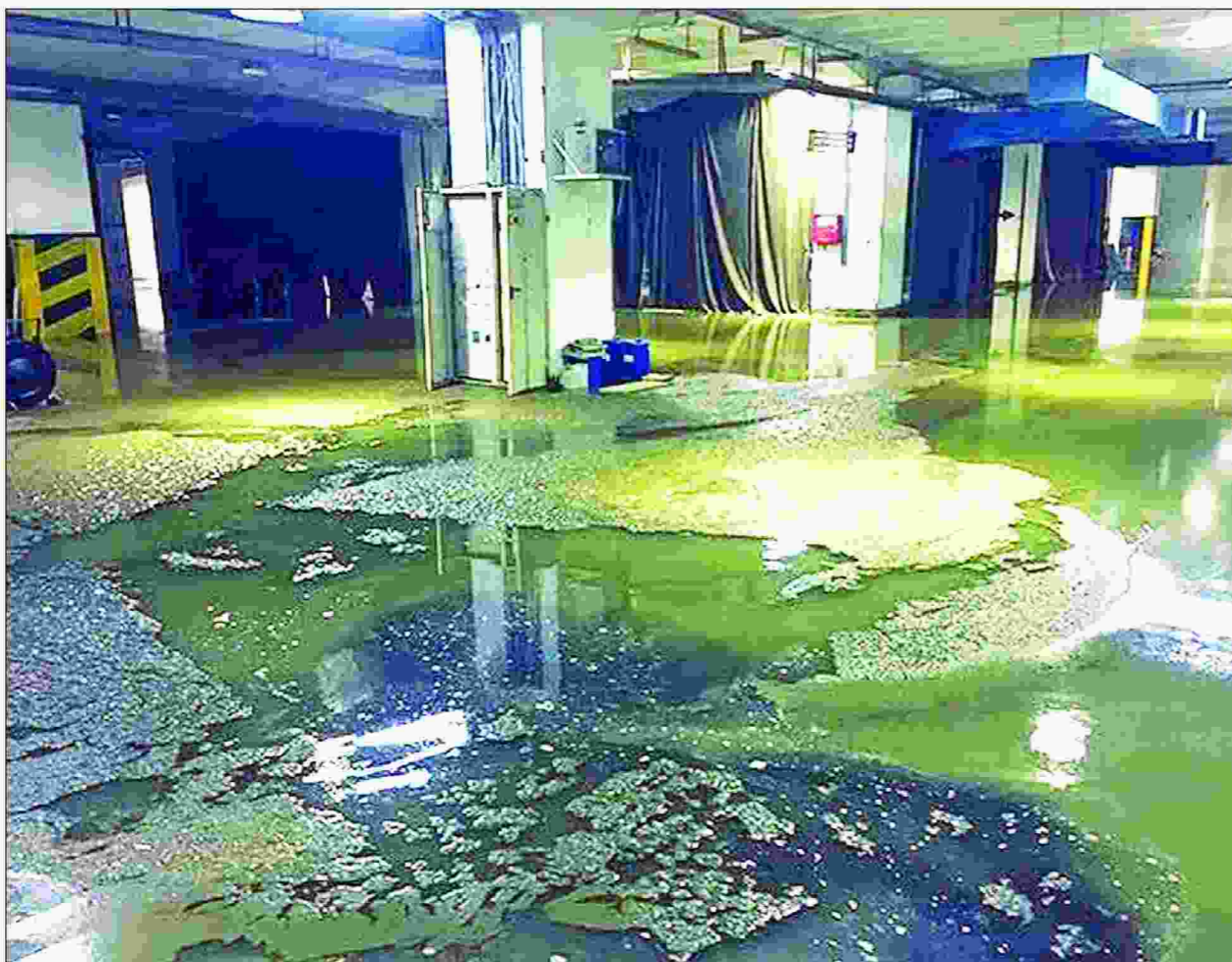
Η εικόνα ντροπής από τα λμνάζοντα νερά που έχουν μετατραπεί σε έλη στο εσωτερικό του πρώην αεροδρομίου στο Ελληνικό
