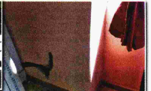
Εμφανείς οι ρωγμές σε κάθε τοίχο του Ψυχιατρικού Τμήματος από τον περσινό σεισμό
