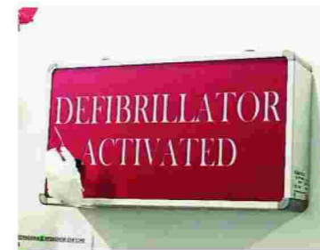
Συναγερμός που ειδοποιεί για τη χρήση απινιδωτή σε χώρο του ΔΑΑ.
