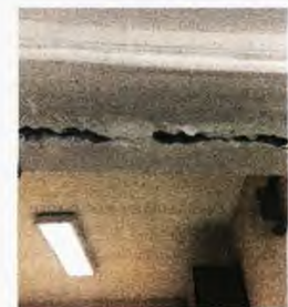
Η ρωγμή θυμίζει την άλλοτε μεσοτοιχία που γκρεμίστηκε παράνομα για συνενωθούν δύο κτήρια
