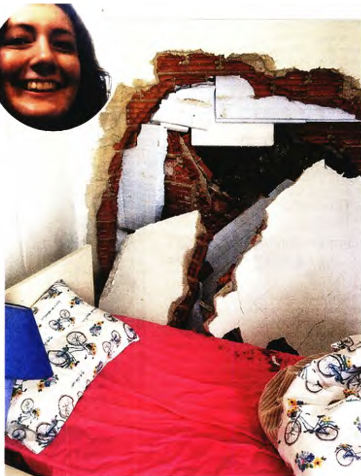
● Η ζημιά που προκάλεσε ο βράχος στο δωμάτιο της αγροτικής ιατρού, Αναστασίας Βλάχου, στο χωριό Μέλανες Νάξου, όταν αποκολλήθηκε από το βουνό μετά την κατολίθηση
