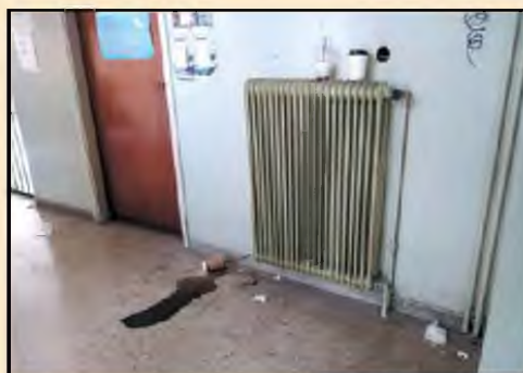
Τίποτα δεν έχει αλλάξει εδώ και πέντε μήνες στον ΕΟΠΥΥ του Πειραιά. Ο ένας ανελκυστήρας εξακολουθεί να είναι εκτός λειτουργίας
