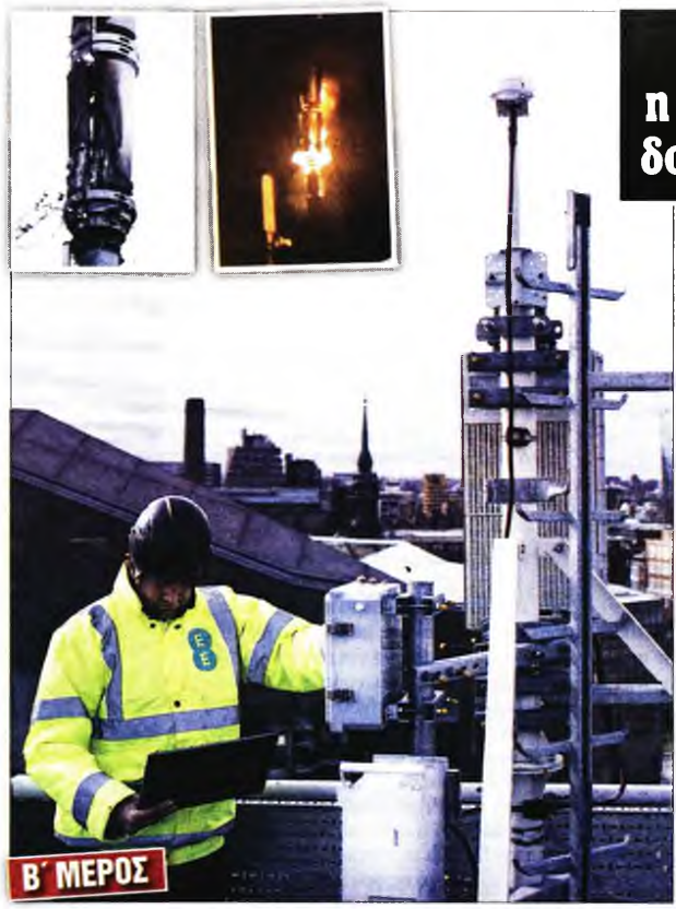
Τεχνικός τηλεπικοινωνιών κάνει εργασίες σε κεραία 5G στο Λονδίνο, κατά τη διάρκεια των δοκιμών του δικτύου τον Μάρτιο του 2019. Στην ένθετη φωτο: Κεραίες 5G γάλλων από διαμαρτυρούμενους πολίτες στο Λονδίνο πριν από έναν μήνα, εν μέσω της πανδημίας του Covid-19
