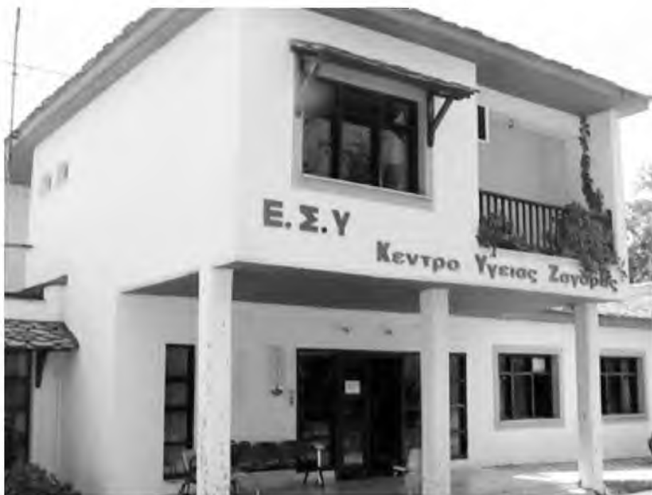
Το πρόβλημα στη στέγη, που μπάζει νερά, παραμένει, παρά τη διάθεση χρημάτων για έργα
