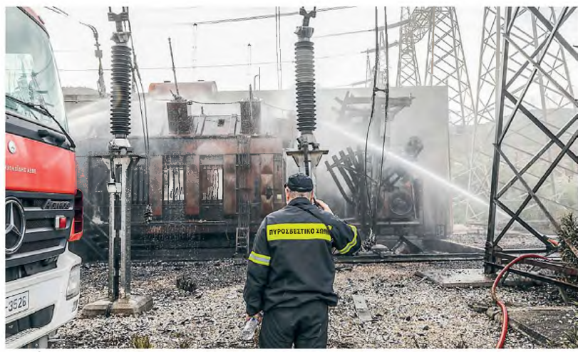
Η φωτιά στο ΚΥΤ Κοιμουνδούρου έξασπε έπειτα από έκρηξη σε έναν από τους μετασχηματιστές της εγκατάστασης, ο οποίος σύμφωνα με μαρτυρίες πυροσβεστών είχε το μέγεθος ενός κοντέινερ και περιεείχε 80 τόνους λάδι που χρησιμοποιείται από το σύστημα ψύξης.
