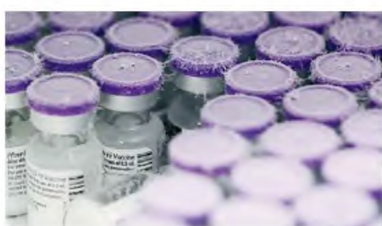
Υπήρξε βλάβη στον ηλεκτρολογικό πίνακα στο Δρομοκαίτειο, με αποτέλεσμα να σταματήσει η λειτουργία του ψυγείου όπου είχαν αποθηκευτεί τα φιαλίδια εμβολίου.
